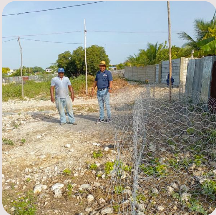
MURO GAVIONES MANIEL
